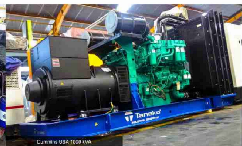
Cummins USA 1000 kVA
